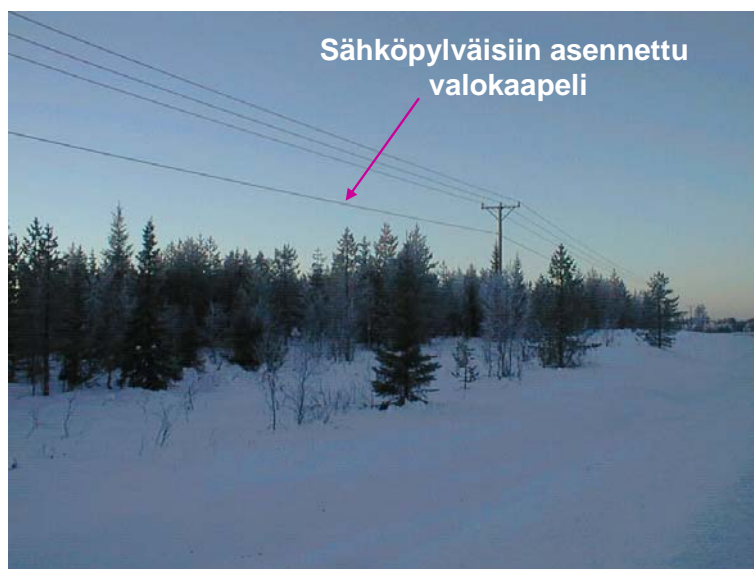
Esimerkki ilmakuitukaapeliratkaisusta (Pohjois-Ruotsi)
